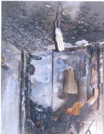
11. kép: A szellőző akna képe a tűz után. Jobbra a konyhai szagelszívók, balra a fürdőszobai szellőzés alumínium vezetékei. Jól látható az „éghető” papírrácsbetétes farostlemez akna elhatárolás
