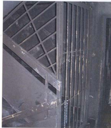
8. kép: A tetőszintre vezető lépcsőházat lezáró rács, mögötte a hő- és füstelvezető működtető szerkezete
