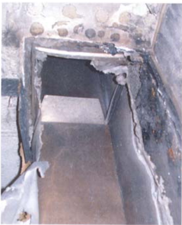
12. kép: Az akna belső képe. Jól láthatók a nyomai egy, a közelmúltban elvégzett tisztításnak, továbbá látható a földem vonalában a tűzgátló elzárószervezet hiánya
