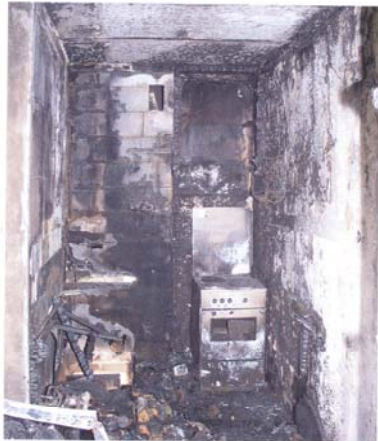
6. kép: A VI. emeleti lakás konyhájának belső képe, az áthelyezett tűzhellyel (tűzkeletkezési hely). Megfigyelhető a gépészeti akna jó tűzállóságú Ytong falszerkezete és az eredeti szagelszívó csatlakozás
