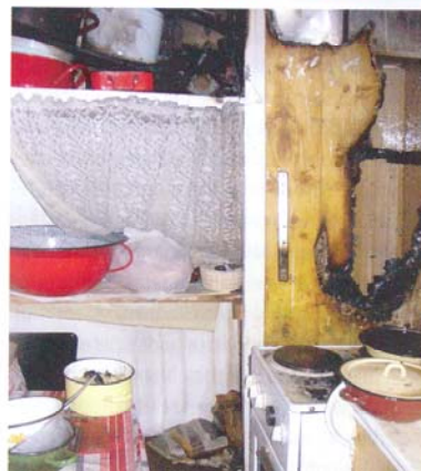
2. kép: A Fényes udvar 6. sz. alatti lépcsőház földszint 2 sz. lakás konyhája (a tűzkeletkezés helye), a tűzhellyel és a szagelszívó akna éghető burkolatával, amely elsőként gyulladt meg
