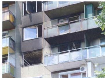
5. kép: A Budapest, XV Páskom park 35. sz. alatti épület homlokzati részlete; a legalsó károsodott lakás a tűzkeletkezési hely a VI. emeleten
