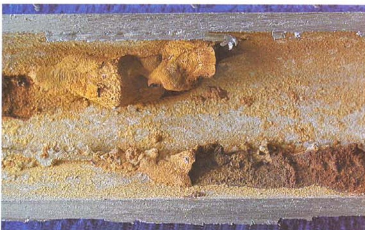
2. ábra. Korróziós termék – alatta lyukadás – kb. egy éve üzemelő hg. csőben
