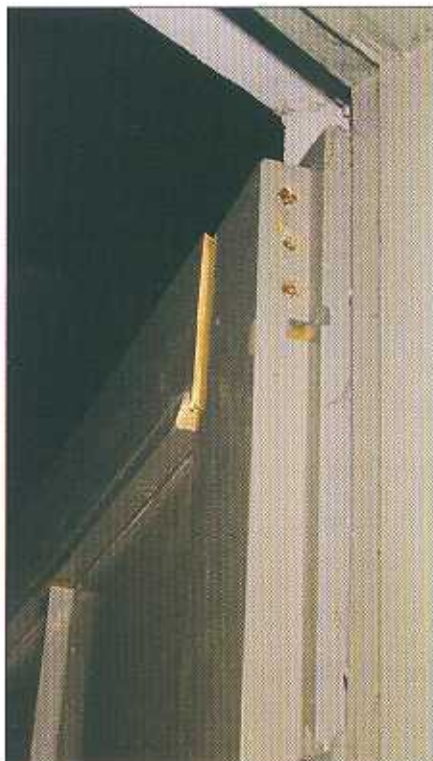
Szakszerűtlen csapozás javítás.
