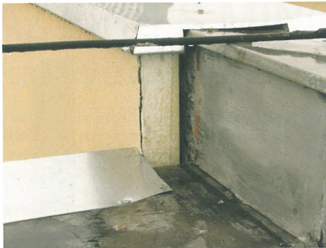
Befejezetlen csomópont: a hőszigetelés lezáratlan, a falfedésnek csak a rögzítőszegélye készült el
