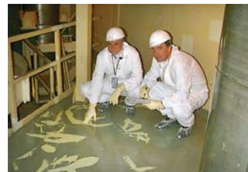
A dekontaminálható felületek kompaktsága szigorú követelmény. A repedésjavítás ellenőrzése
