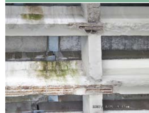
A Puskás Ferenc Stadion károsodott gerendái
