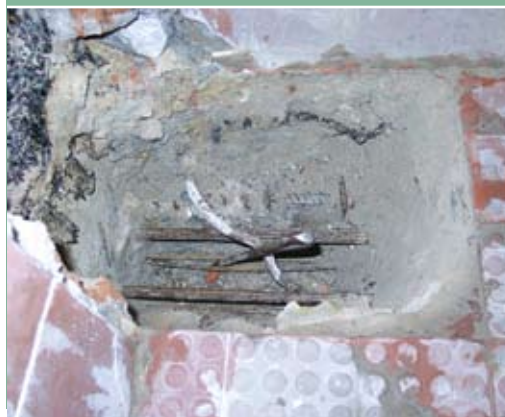
Korrodált és laza feszítőhuzalok IMS szerkezetben
