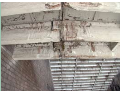
Károsodott gerendavégek a Puskás Ferenc Stadion galériaszintjén
