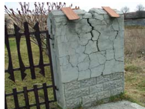
Mozaikos repedés a kerítésen
