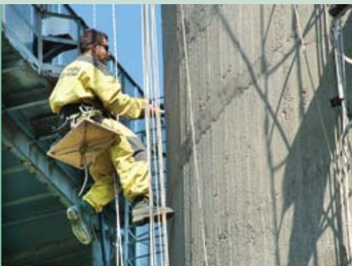
Vasbeton kéménytest vizsgálata
