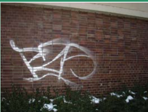
Az eredeti állapot helyreállításához szakértelem és sok pénz szükséges
