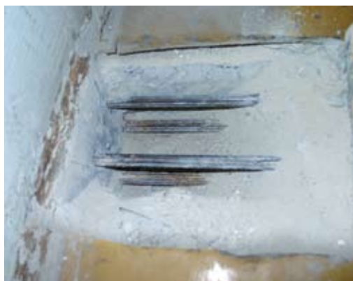
Feszítőhuzalok korróziója IMS szerkezetben
